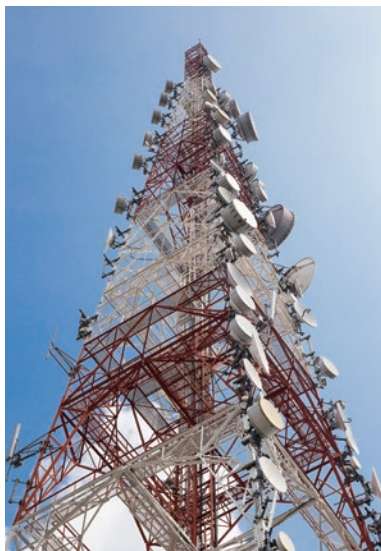
ミャンマーの通信塔
