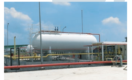
ガス一括供給施設
