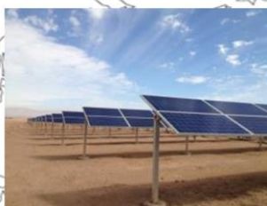
ペルー マハス太陽光発電所 (22MW)
