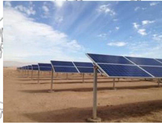
ペルー マハス太陽光発電所 (22MW)
