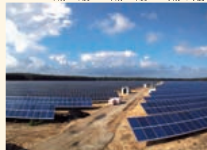
ドイツの太陽光発電所
