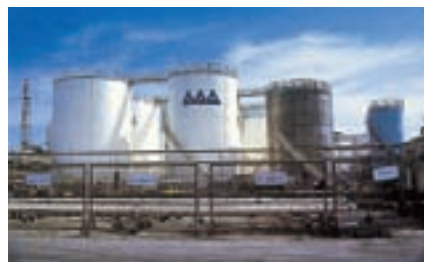
タイで展開しているN.I.M.社の化学品タンクヤード（倉庫）
