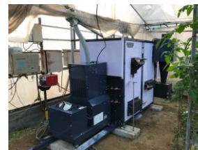
バナナ農園に設置したバイオマスボイラー
